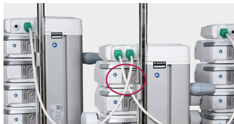
Figure 3: Nieprawidłowe podłączenie trzech kolumn; kable krzyżują się.
